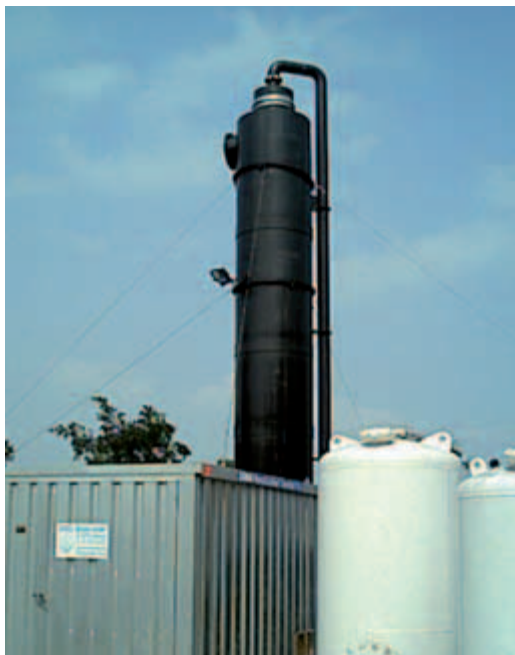
Turmstripper TS 10 mit nachgeschaltetem Aktivkohlefilter und Gerätecontainer
