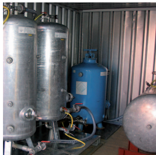
AKA 7 montiert in einem geschlossenen Gerätecontainer
