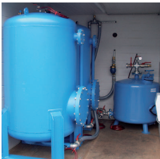
AKA 10 montiert in einem geschlossenen Gerätecontainer
